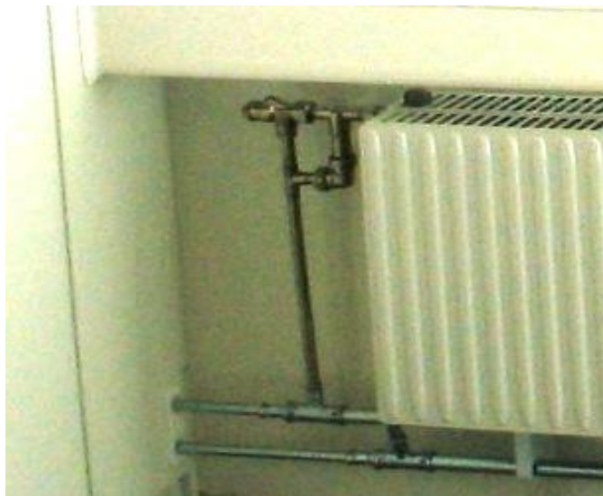
Figur 33: Radiatorkoppel för värme- eller kyl drift av radiatorer på Akzo Nobels kontor i Stenugnsund.
